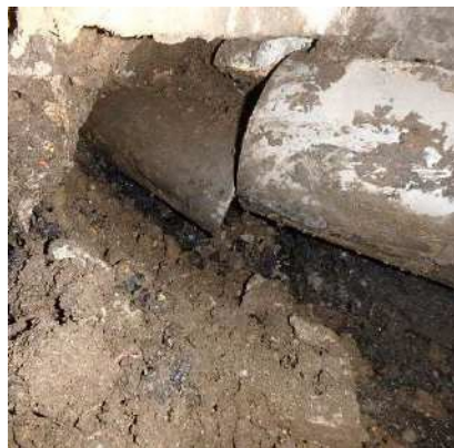
排水管の破損による漏水
