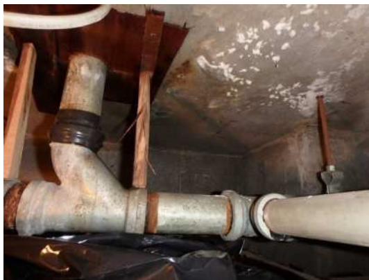
排水設備や浴室防水からの漏水
