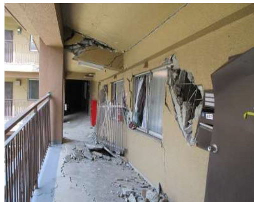
大破したマンションの共用廊下
