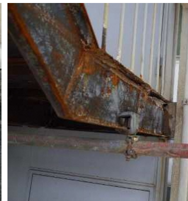
鉄骨階段支持部材の腐食
