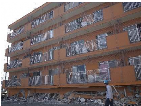
1階部分が圧壊したマンション
