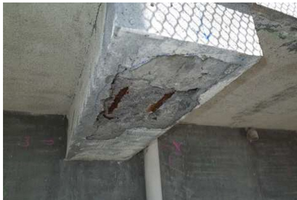
鉄筋の腐食、爆裂
